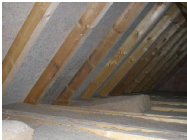
Schimmelpilz in der Dämmung durch Neubaufeuchte. Der Bauherr hatte nicht ausreichend gelüftet.
