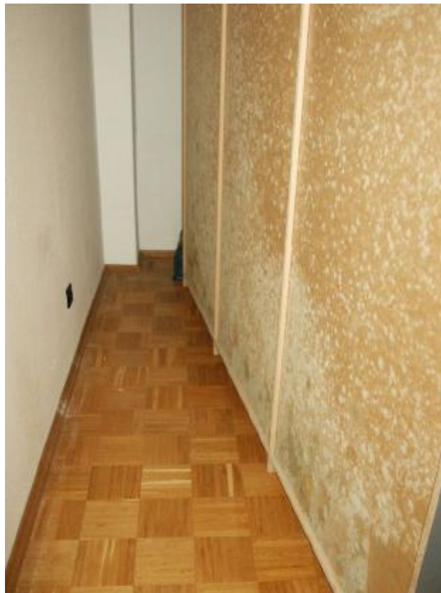
Schimmelpilzbildung durch Kondensation: unsichtbar an der Wand; sichtbar an der Rückwand des Schrankes
